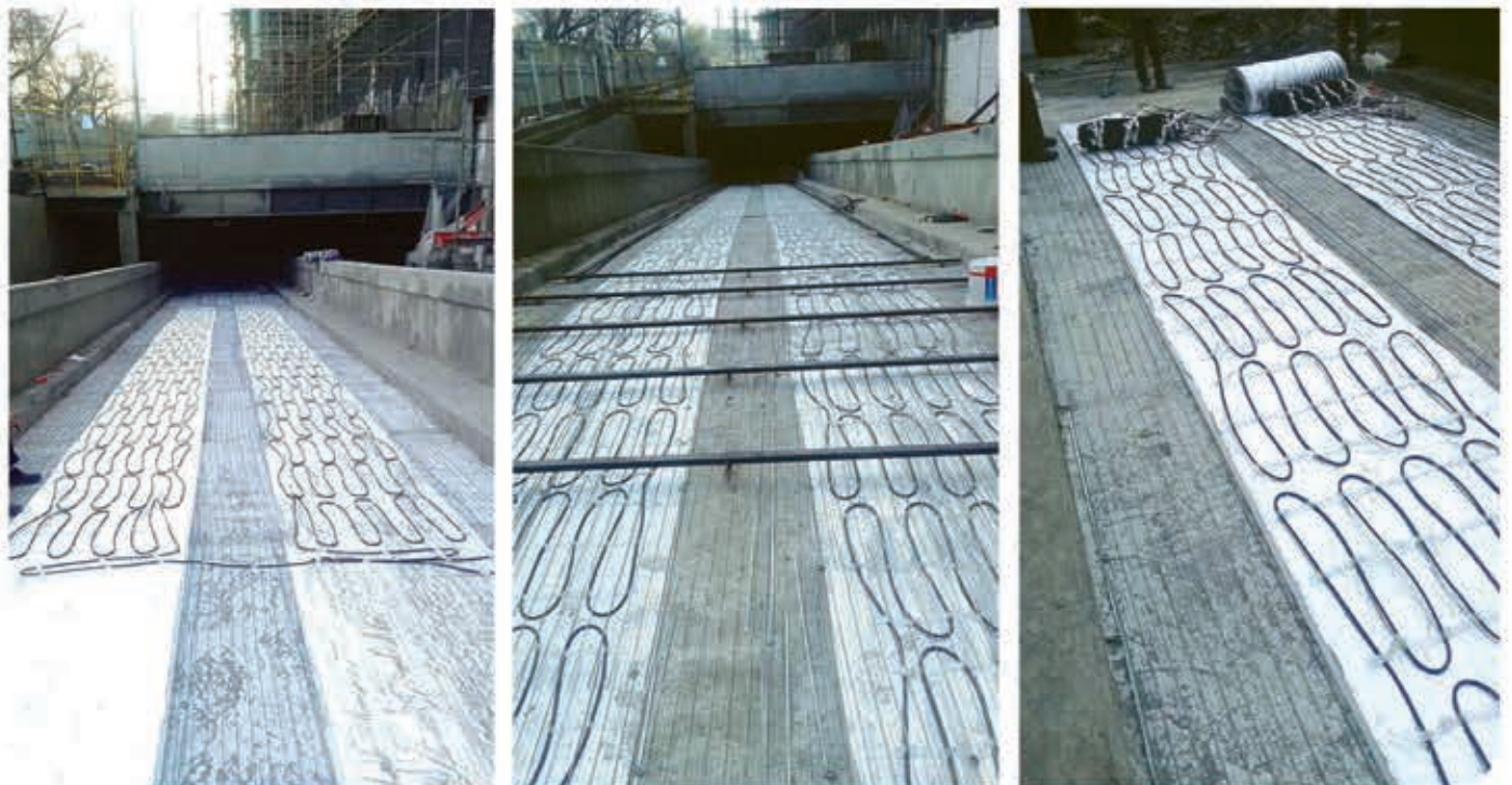
تجهیز رمپ خودرو به سیستم هوشمند ذوب برف و یخ الکتریکی (اجرا: زمستان ۹۶)
